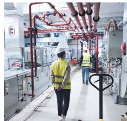
2.500 Datenpunkte zeichnen für das Building Management System (Gebäudeleittechnik) Temperaturen, Luftfeuchtigkeiten, u. a. auf.
