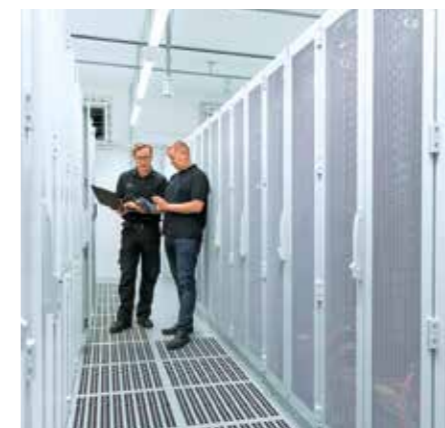
Alle kritischen Versorgungssysteme sind mehrfach ausgelegt und sorgen für höchste Ausfallsicherheit.
