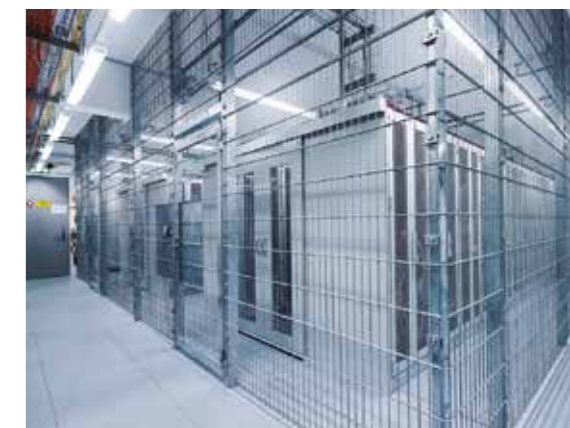
Das neue Data Center verfügt über ein ausgefeiltes Sicherheitskonzept.
