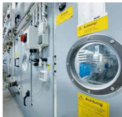
Etwas andere Dimensionen: Auch im Bereich der Klimatechnik, die an insgesamt 80 Cooling Units angeschlossen ist.
