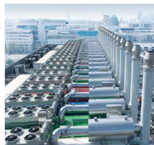
Ein markantes Bild: Die 20 Container-Netzsetsanlagen (NEA) auf dem Dach des Gebäudes in 36 m Höhe.
