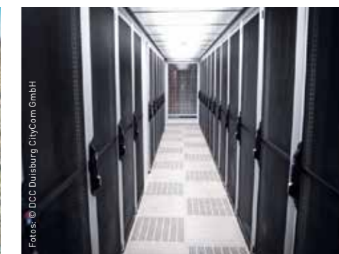
Das Rechenzentrum ist auf dem neuesten Stand der Technik, um die besonderen Ansprüche der Kunden zu erfüllen.
